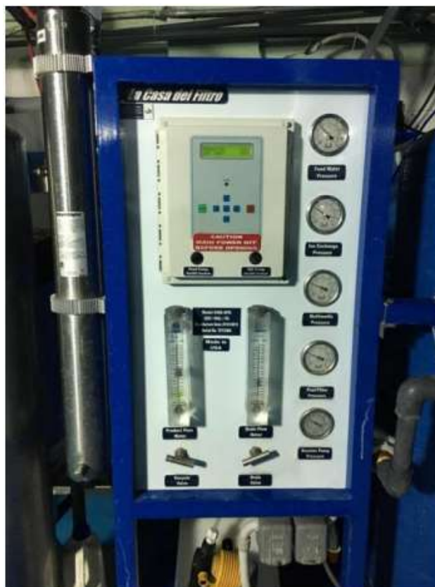
Figura 16. Tablero de control planta purificadora 2
