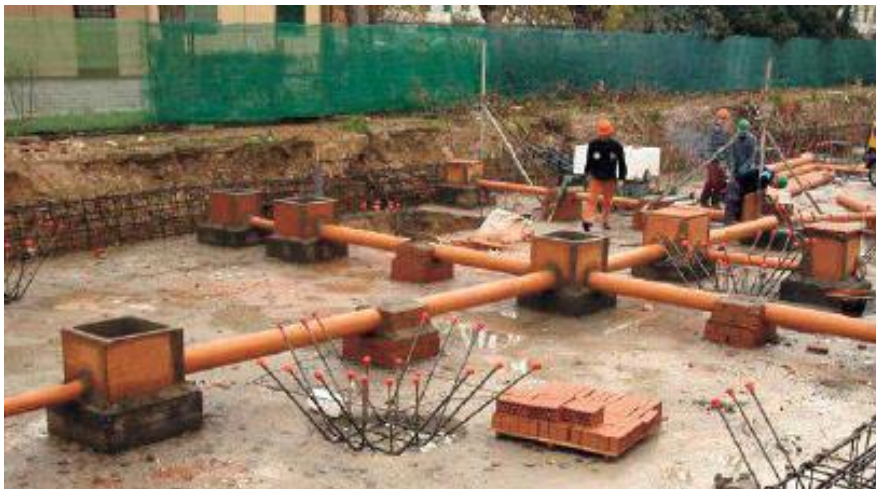
Ilustración 20. Red de colectores enterrados.
