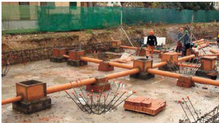
Ilustración 47. Red de colectores enterrados.
