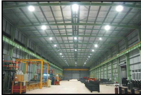
Fotografía 7: Iluminación industrial - LED
