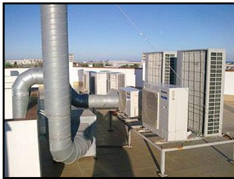
Fotografía 6: Sistema de climatización - ventilación
