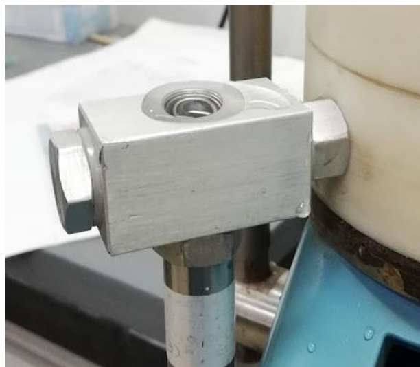
Figura 5.8. Verificación del paso del agua en el sensor.
