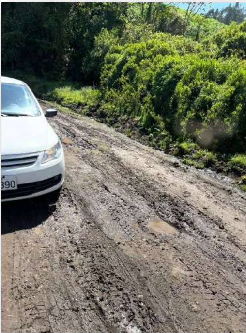
Ilustración 37 Via en pésimas condiciones
