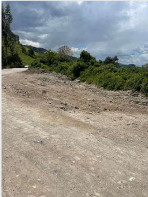
Ilustración 27 Presencia de escombros en la via
