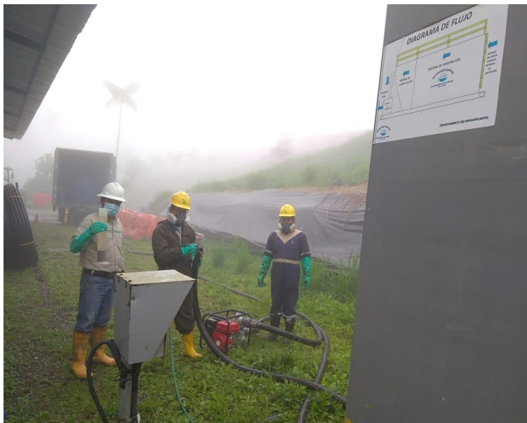
Figura 6. Evacuación de residuos peligrosos líquidos, campamento Rocafuerte (enero de 2021).
