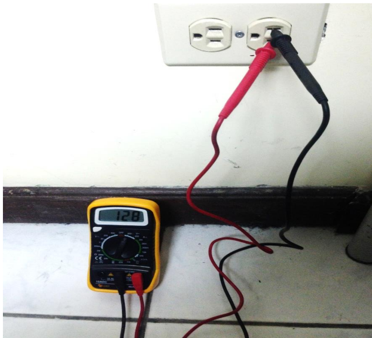
Ilustración 4.15: Medición voltaje en tomacorriente
