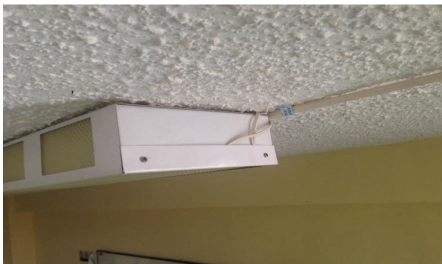
Ilustración 4.3: Cables dentro de canaletas
