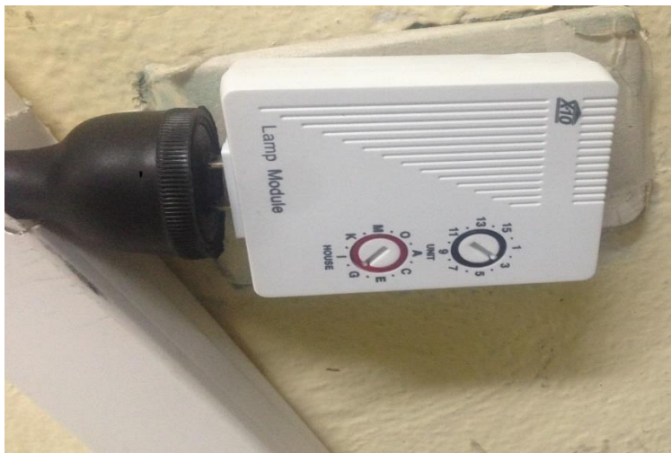
Ilustración 4.9: Fallas en Modulo de lámpara LM465
