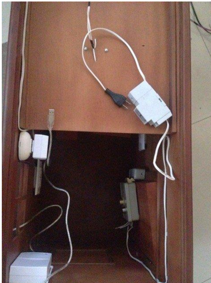
Ilustración 4.30: Instalación de dispositivos X10
