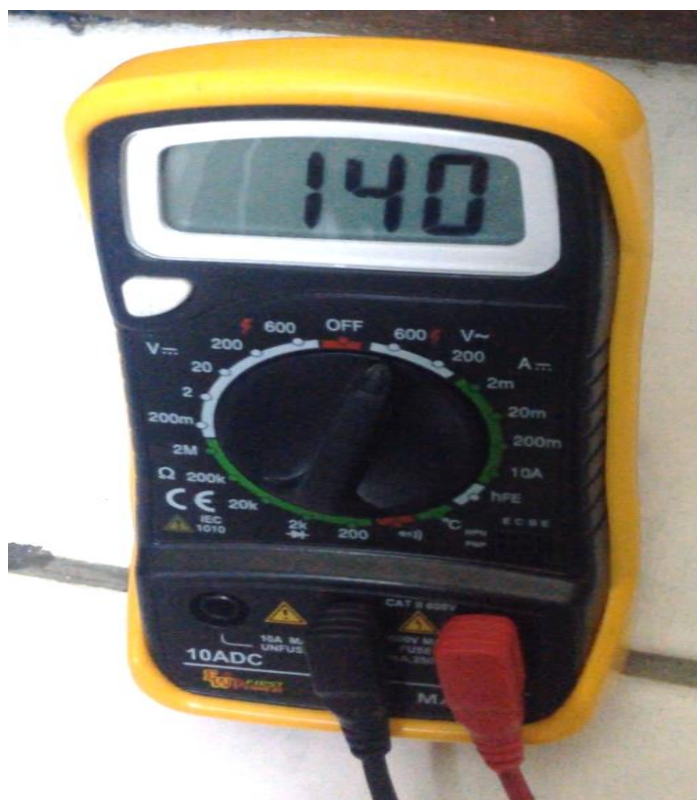
Ilustración 4.17: Medición voltaje en tomacorriente 2
