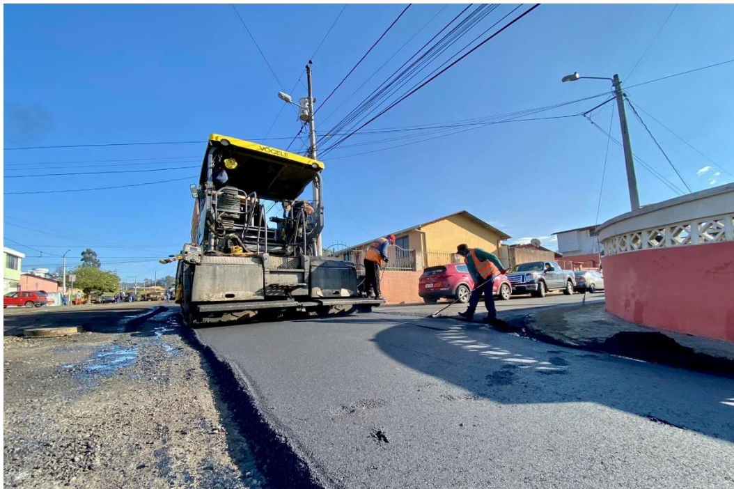
Figura 23. Proceso de reasfaltado, intersección de calles Carlos Alberto flores con Pedro Tobar, 2022, Guaranda, Ecuador. Fuente: Municipio de Guaranda.
