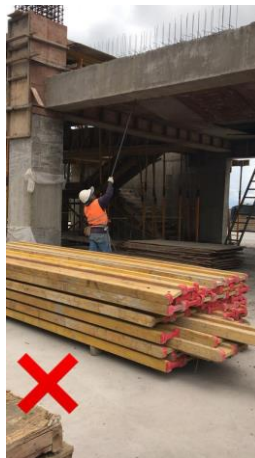
Ilustración 45.- Mala apilamiento de material. Riesgo de desplome.
