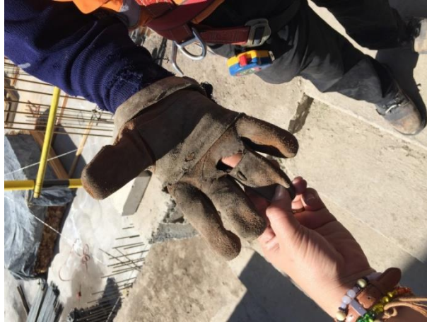
Ilustración 60.- Equipo de protección personal en mal estado.
