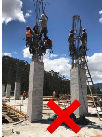
Ilustración 16.- Riesgo de caída de personas en el armado de columnas.
