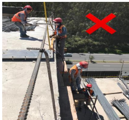
Ilustración 33.- Almacenamiento de materiales para armado inadecuado.
