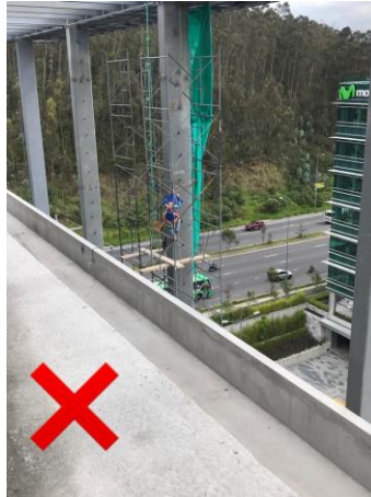
Ilustración 18.- Uso de andamios sin tarjeta de verificación.
