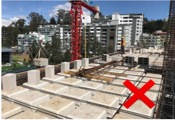
Ilustración 23.- Acumulación de materiales sobre el suelo.
