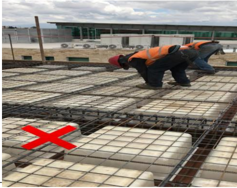
Ilustración 48.- posturas inadecuadas en el armado de losas.
