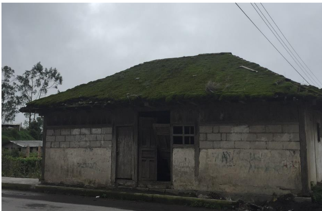
Figura 25: Situaciones de abandono entorno a infraestructura dentro de la parroquia.
