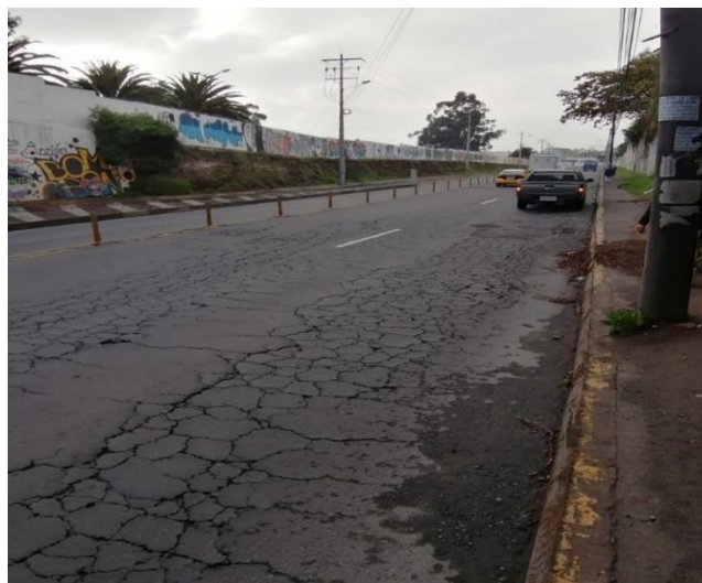
Figura 30. Imagen de las condiciones físicas del asfalto en la Avenida San Francisco de Rumihurco. Elaborado por: José Jaramillo y Ángel Espinel
