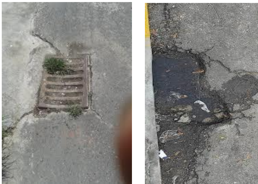
Figura 33. Imagen del mal estado de las alcantarillas. A: Avenida San Francisco de Rumihurco. Elaborado por: José Jaramillo y Ángel Espinel
