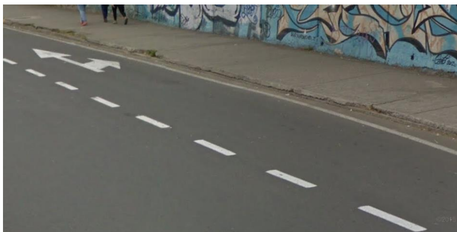
Figura 32. Imagen del estado del pavimento en la avenida Mariscal Sucre. Elaborado por: José Jaramillo y Ángel Espinel
