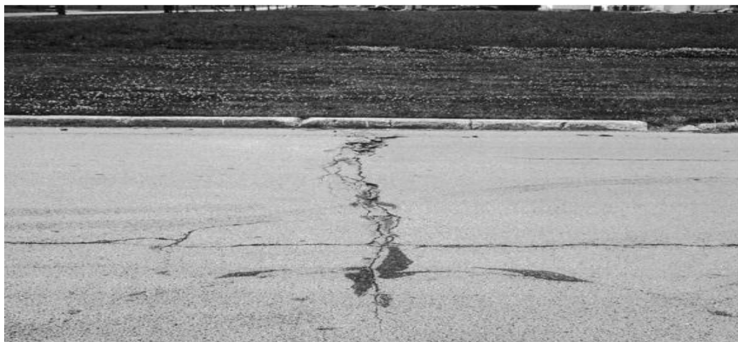
Figura 2.9 Ejemplo de falla longitudinal y transversal de alta severidad
