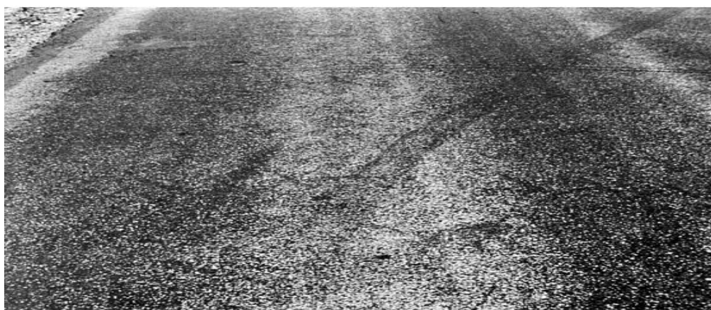
Figura 2.5 Ejemplo de exudación de severidad baja
