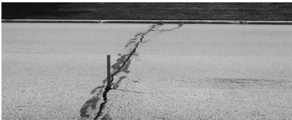
Figura 2.8 Ejemplo de fisura transversal de mediana severidad
