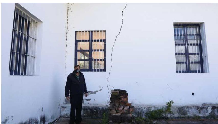
Figura No. 1 Daños Causado en la Casa Hacienda Carcelén
