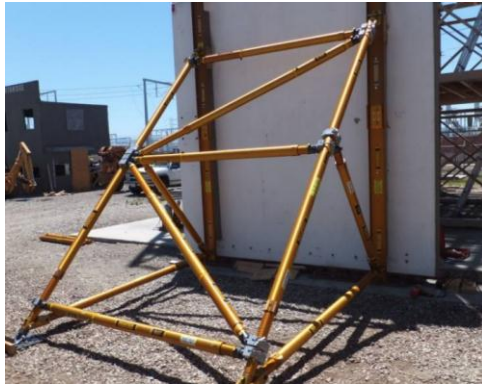
Ilustración 37: Sistema de apuntalamiento
