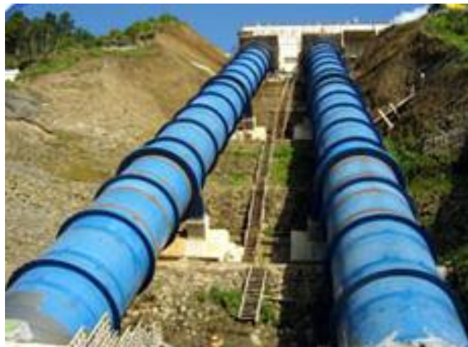
Ilustración 26: Tubería de Presión
