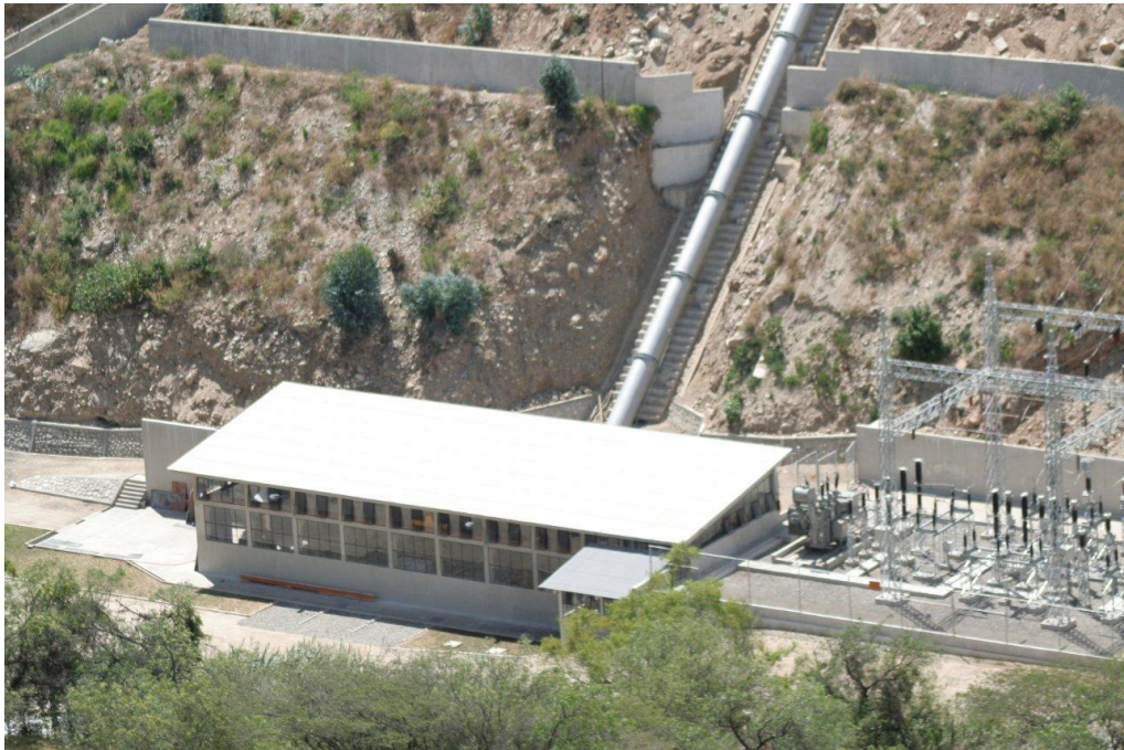
Ilustración 27: Casa de máquinas
