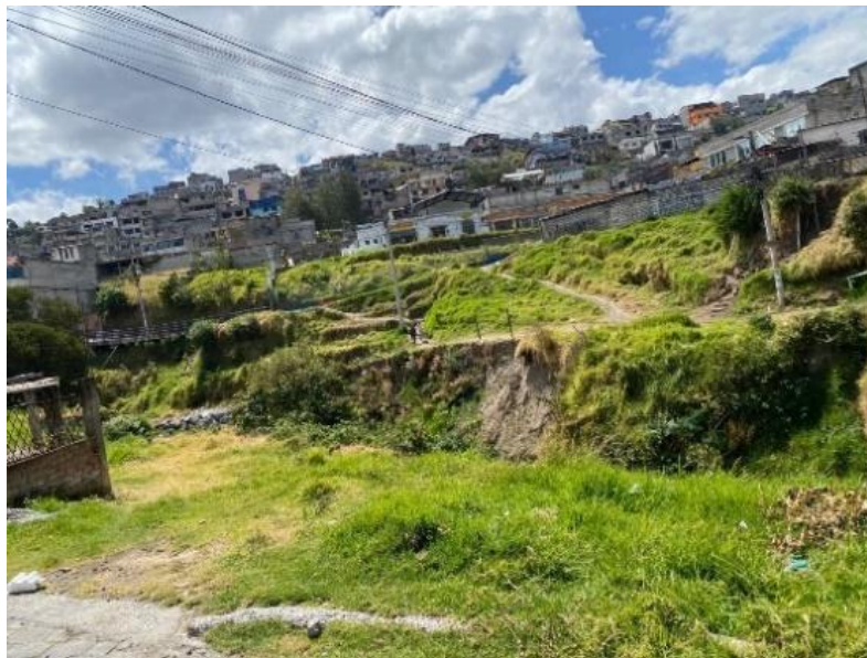
Figura 25. Quebrada Caupicho, zona de intervención 4', desprendimiento de taludes por erosión, vegetación degradada.
