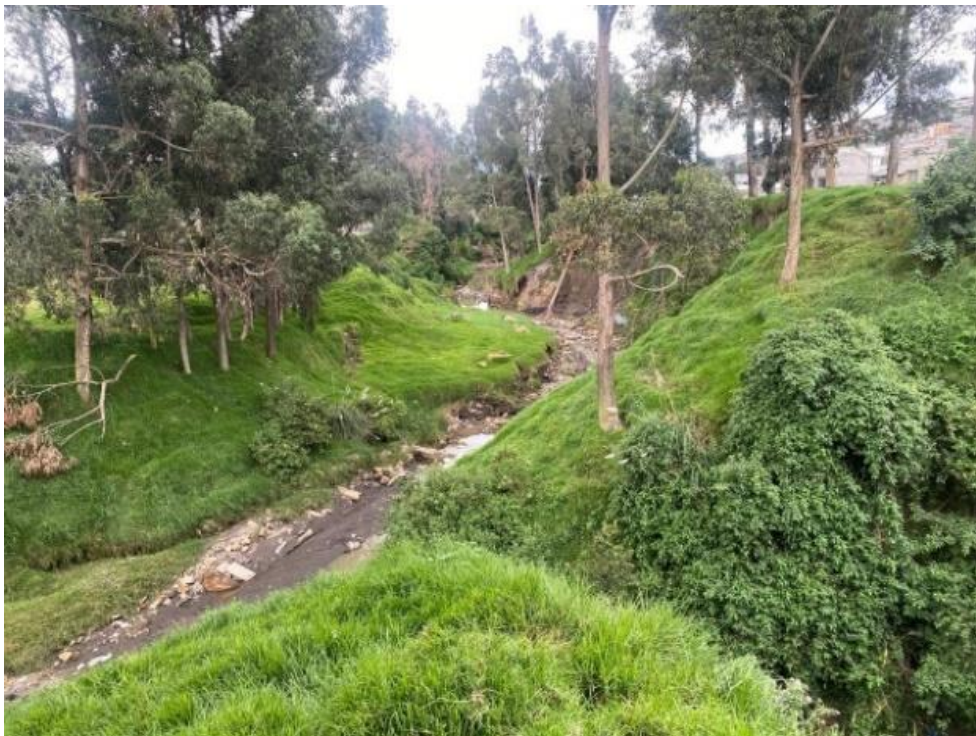
Figura 21. Zona de intervención 4, acumulación de escombros, desprendimiento de taludes
