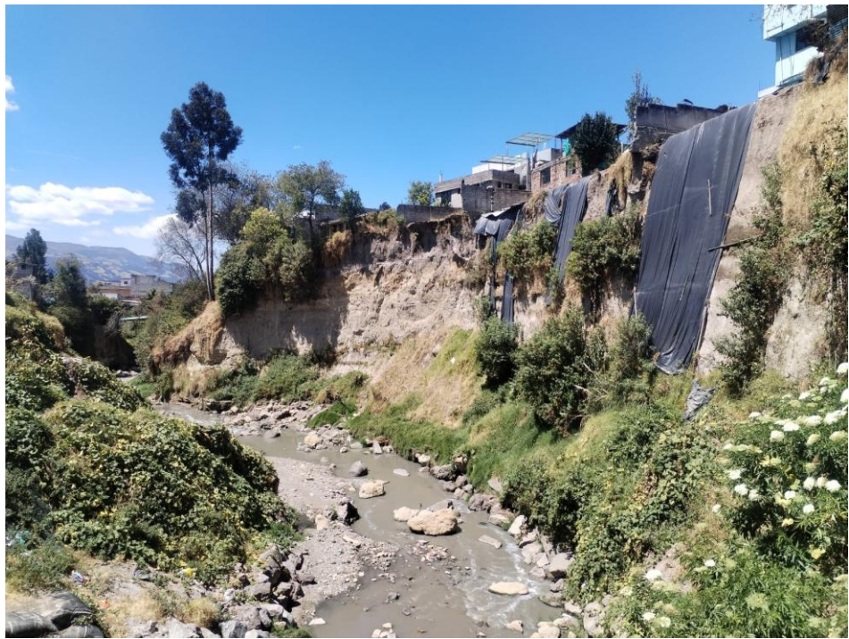
Figura 11. Zona de intervención 2, riesgo de colapso de viviendas por erosión de taludes, degradación vegetal de taludes Fuente: Elaboración propia, 2024
