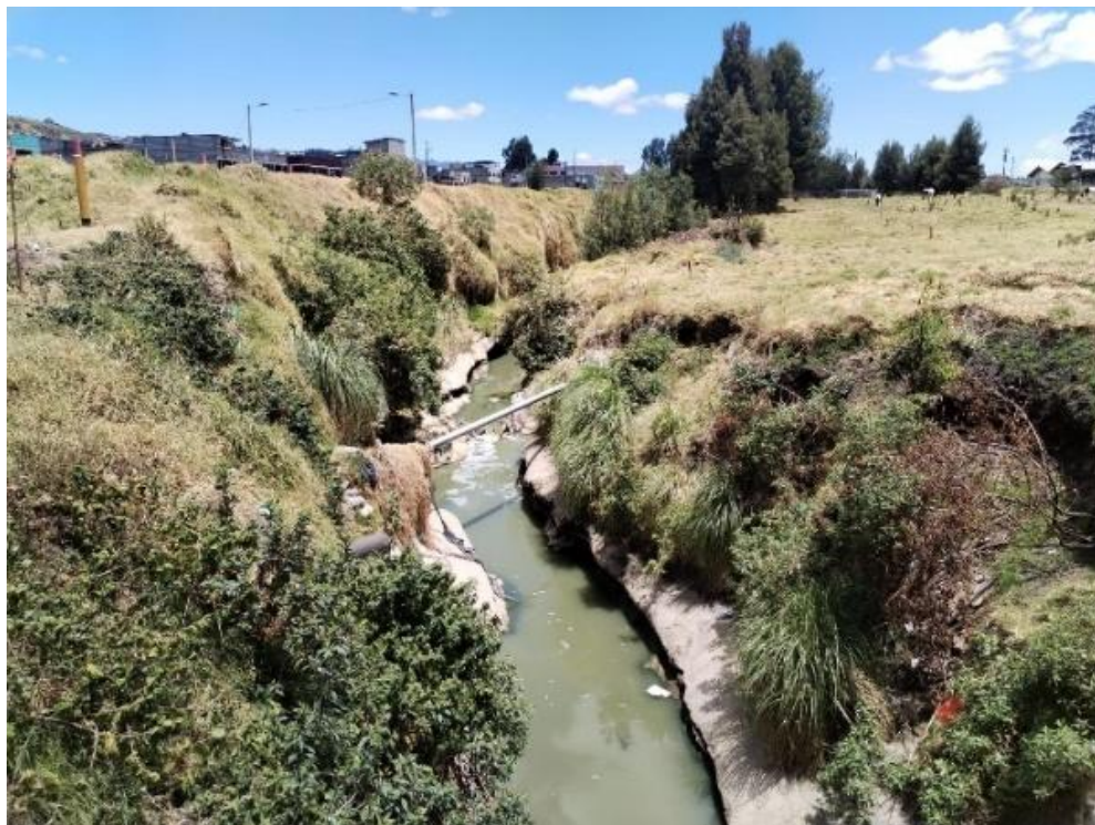
Figura 8. Zona de intervención 1, acumulación de sedimentos y vegetación degradada aquí se ve como el caudal varía por las zonas sin vegetación en las riberas de la quebrada,
