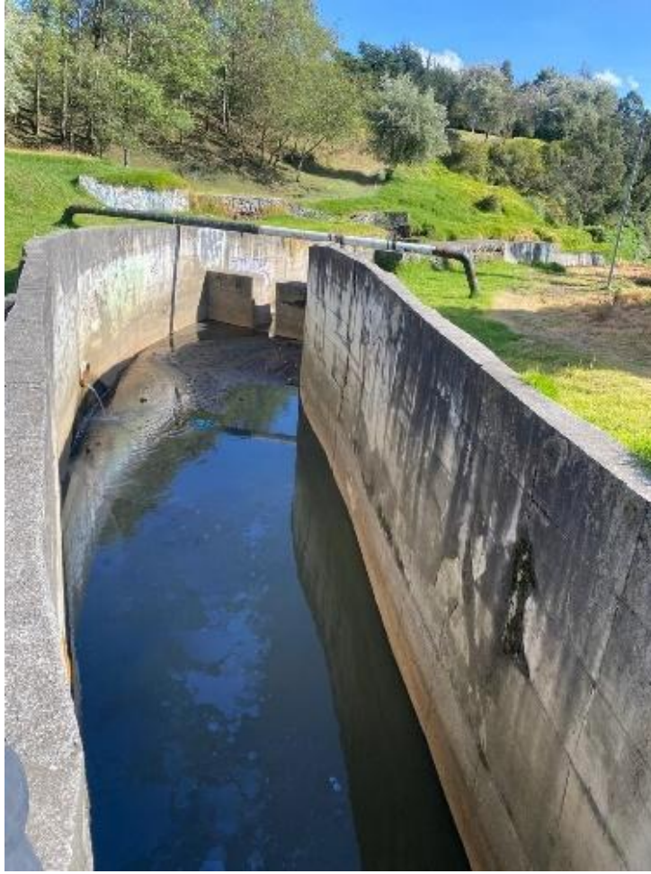
Figura 24. Zona de intervención 4' – muros de hormigón armado que evitan el desprendimiento de taludes
