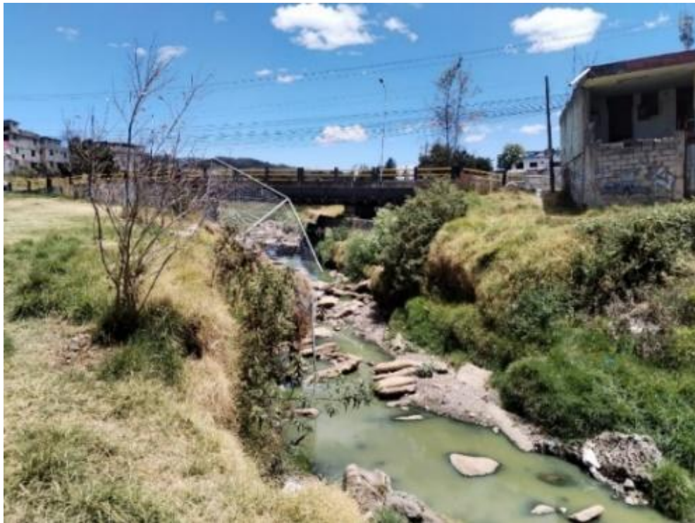
Figura 15. Zona de intervención 3, erosión y desprendimiento de taludes, vegetación degradada, acumulación de sedimentos
