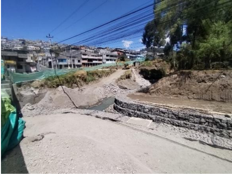
Figura 18. Zona de intervención 4, conformación de muros de gavión en taludes con desprendimiento por erosión para evitar el colapso de la vía Susana Letor Fuente: Elaboración propia, 2024
