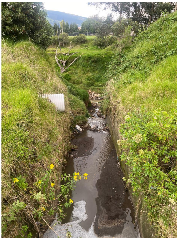
Figura 22. Zona de intervención 4, descargas ilegales de aguas servidas, acumulación de escombros
