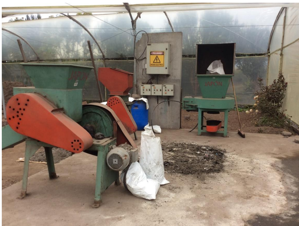
Fotografía 2. Tritadora de residuos orgánicos. Centro de Reciclaje del Cantón Mejía
