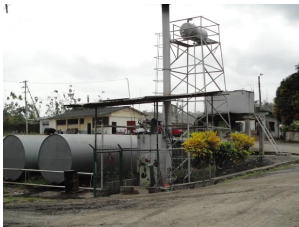
Imagen No.4 Tanques de combustible Fuente: Trabajo de campo
