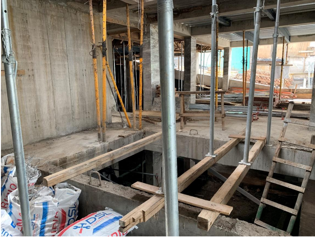
Posibles golpes con puntales o caídas en altura. Elaborado por: Fernández Peralta Jorge Luis
