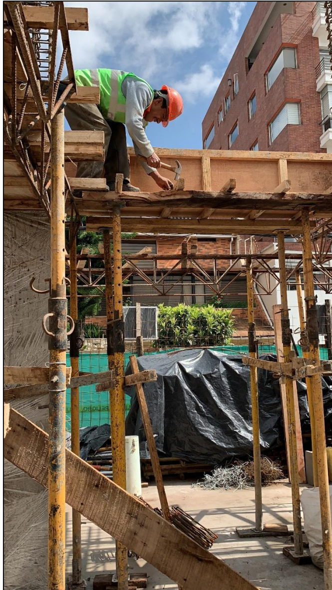
Posible caída y golpes en altura. Elaborado por: Fernández Peralta Jorge Luis
