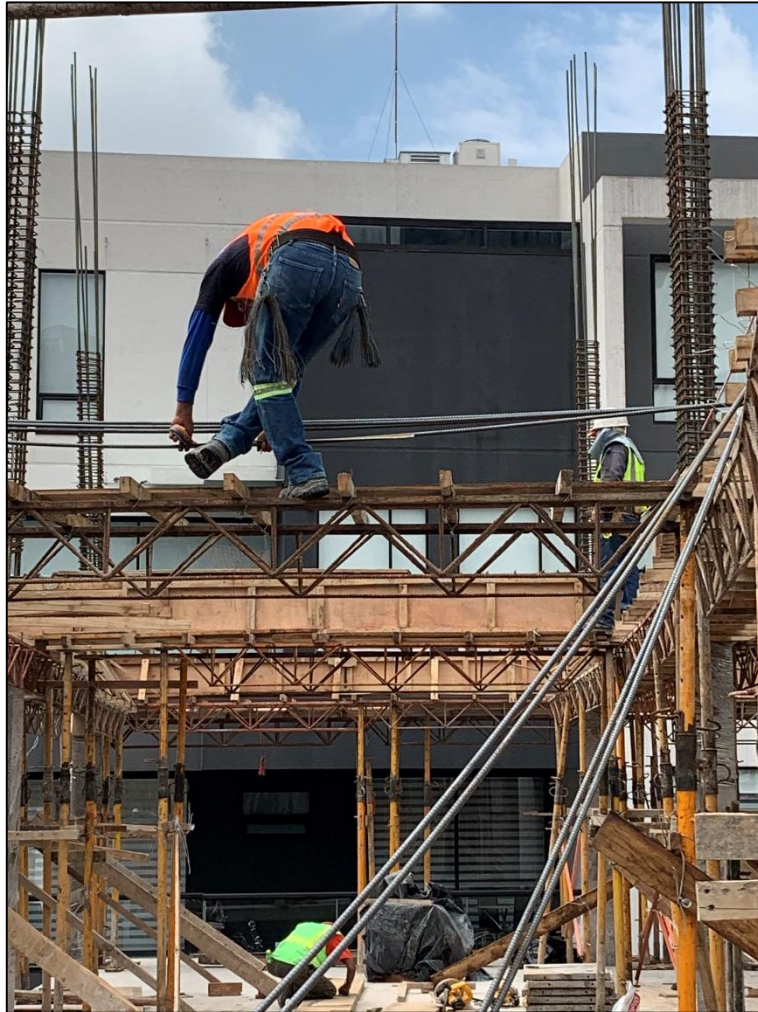
Posible caída y golpes en trabajos. Elaborado por: Fernández Peralta Jorge Luis
