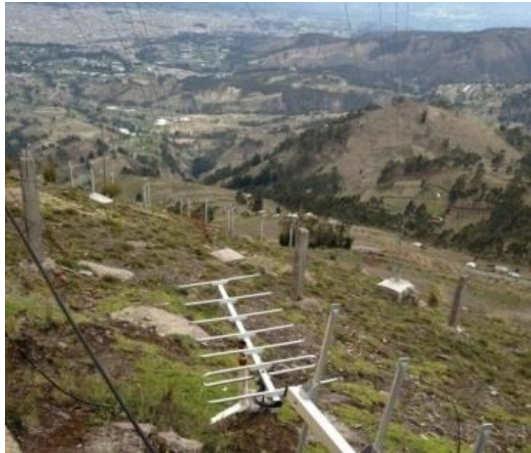
Fuente.- Fotografía de antena de enlace auxiliar – 95,3 MHz.
