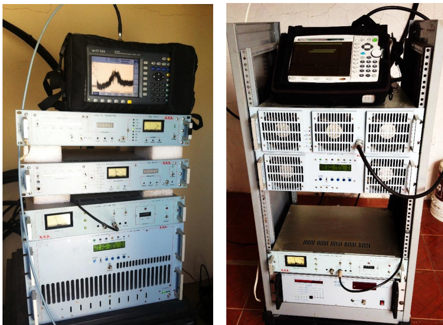
Fuente.- Fotografía de equipos de las radiodifusoras 89,3 y 104,5 MHz
