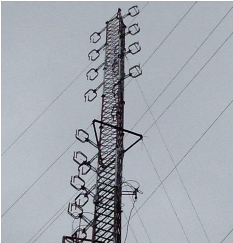
Fuente.- Fotografía de arreglos de antenas – Cerro Cacha.
