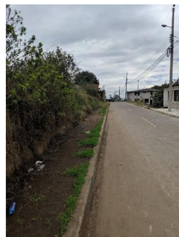
Subsegmento de Acera Incompleta, Calle Isidro Ayora
