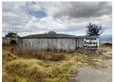
Equipamiento de Infraestructura. Reservorio Intermedio EPMAPS
