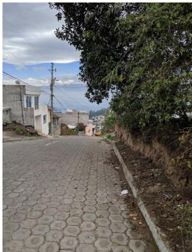
Subsegmento de Acera Inexistente 1, Calle 11 de Febrero
