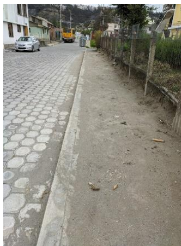
Subsegmento de Acera Incompleta, Calle Quito
