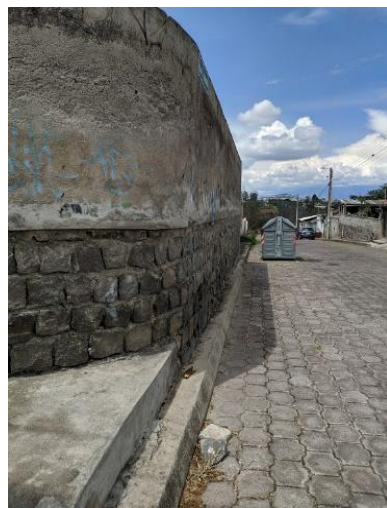
Subsegmento de Acera Inexistente 2, Calle Manabí
