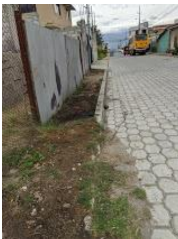
Subsegmento de Acera Incompleta, Calle Quito
