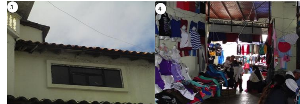
Figura 149 Filtraciones de Agua y Problemas funcionales
