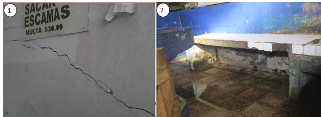
Figura 148 Fisuras y Problemas Sanitarios
