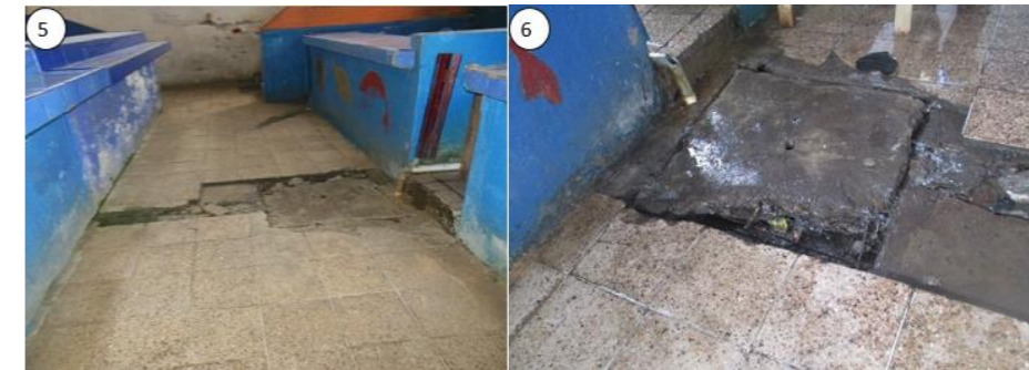
Figura 150 Problemas Instalaciones Sanitarias
