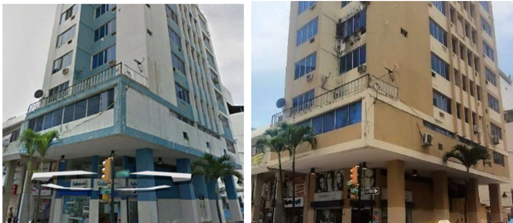
Ilustración 20 Edificios en proceso de abandono 2015- 2023- Esquina Luque y Escobedo Fuente: Fotografías tomadas por el Autor (Google, 2015)
