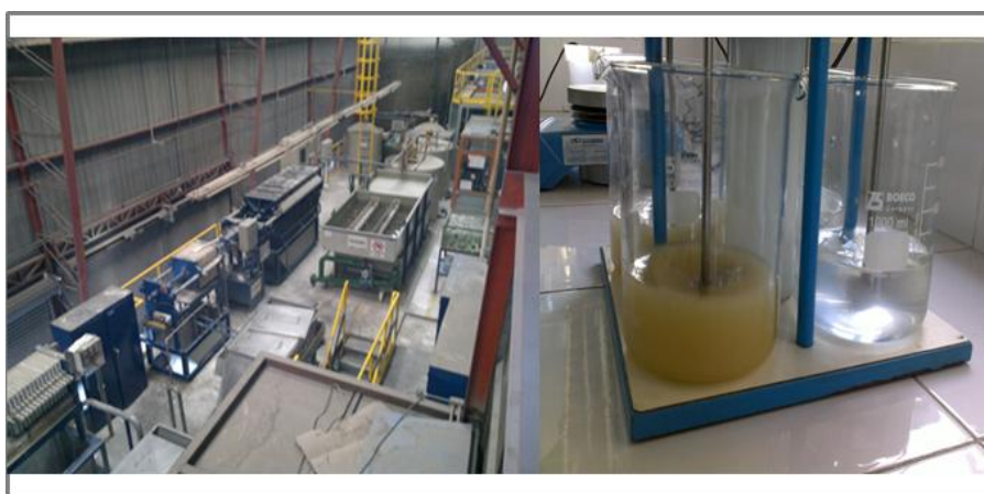
Planta de tratamiento de vertidos GMOBB.
