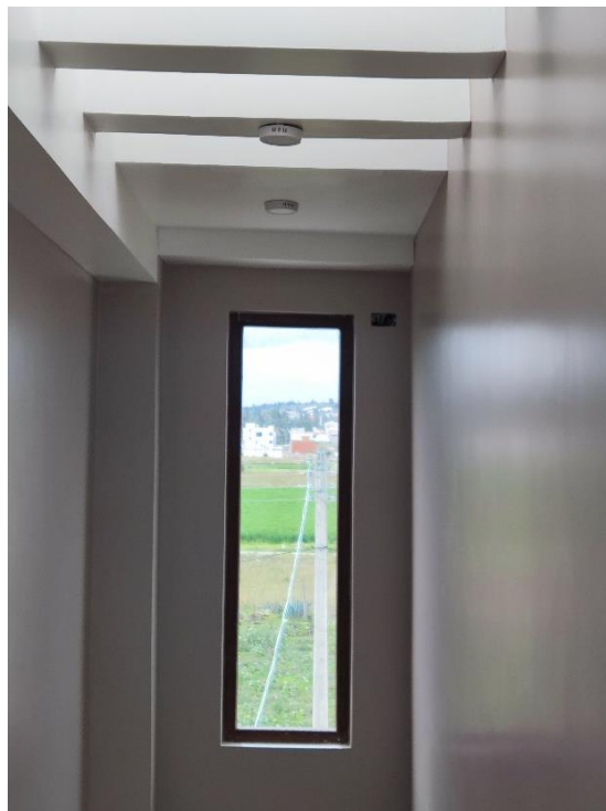
Ilustración 6: Iluminación ingreso segundo piso
