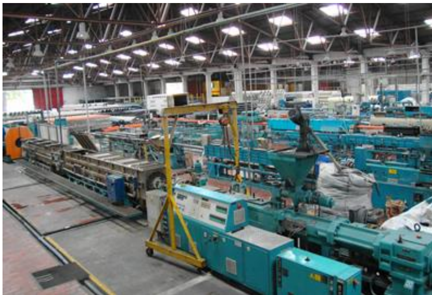
Maquinaria de producción de tubería de PVC y polietileno de alta y baja densidad.
