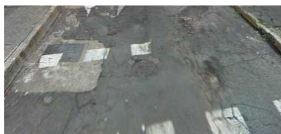
Calle Sincholagua en Mal estado Fuente.: Google Maps
