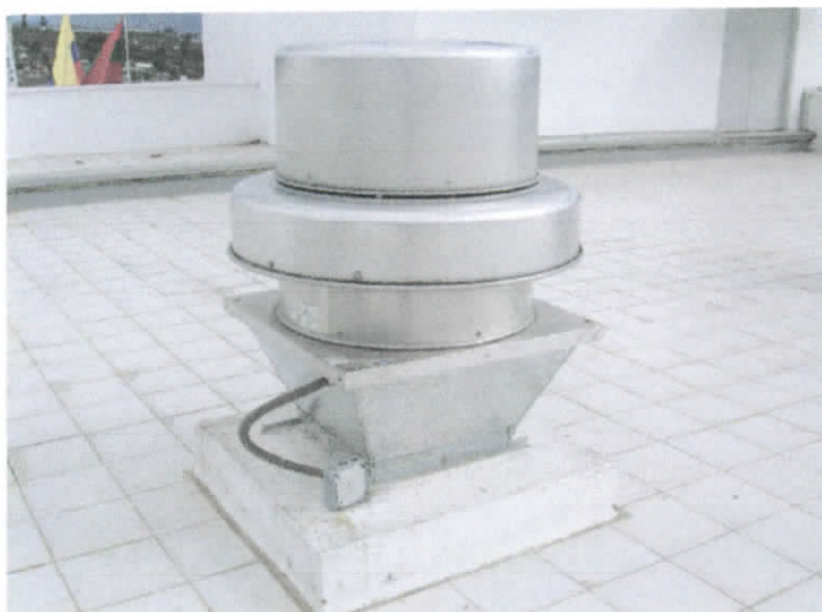
Imagen 66: Equipo extractor de aire tipo hongo. Imagen tomada por el autor
