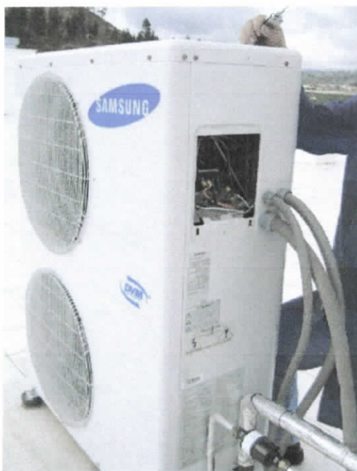
Imagen 65: Equipo Aire acondicionado de flujo variable. Imagen tomada por el autor
