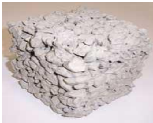
Ilustración 6 Mezcla de hormigón discontinua
