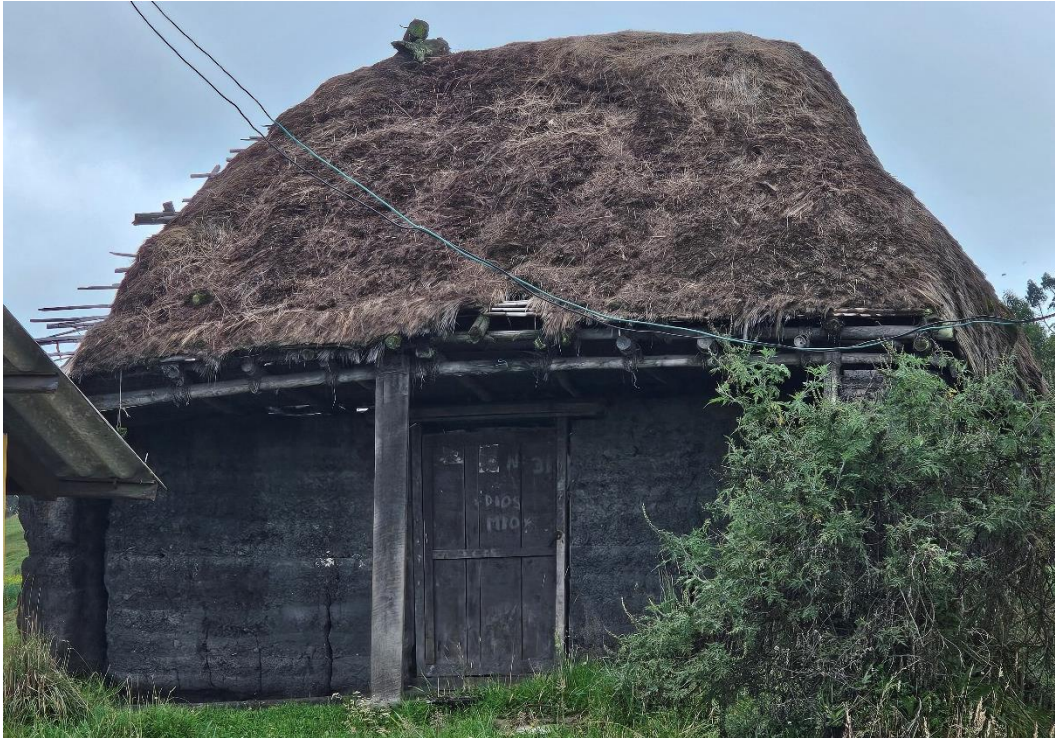
Imagen 32. Choza tipo ubicada en la comunidad La Esperanza, realizada por el autor
