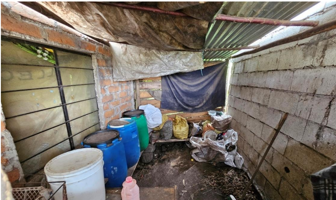
Imagen 52. Bodega improvisada en edificaciones, elaborada por el autor
