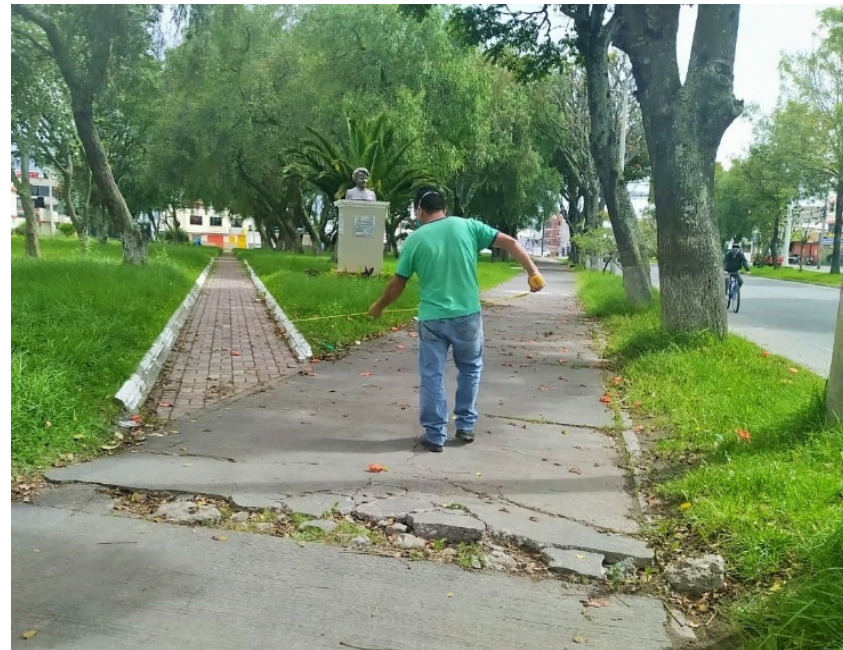
Figura 5 Mal estado de aceras.
