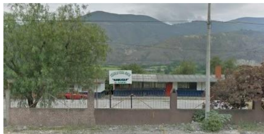
Figura 122: Fotografía escuela sin funcionamiento comunidad El Ramal. Fuente: Daniel Fernando Benavides Guerra.
