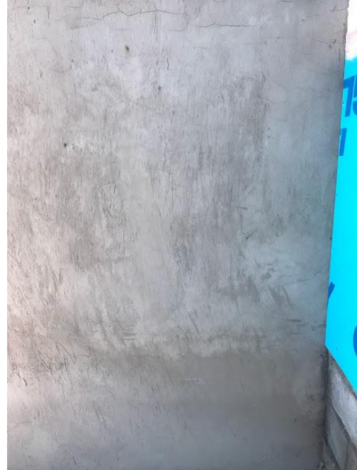
Ilustración 93: Inspección visual a los 7 días, mortero tradicional
