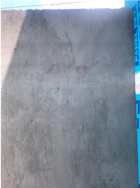
Ilustración 94: Inspección visual a los 7 días, mortero tradicional
