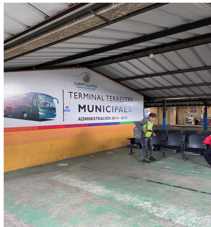
Figura 43: Mal estado del terminal terrestre de Cayambe Fuente: Elaboración propia
