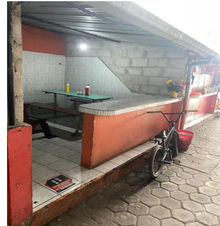
Figura 44: Mal estado del terminal terrestre de Cayambe Fuente: Elaboración propia
