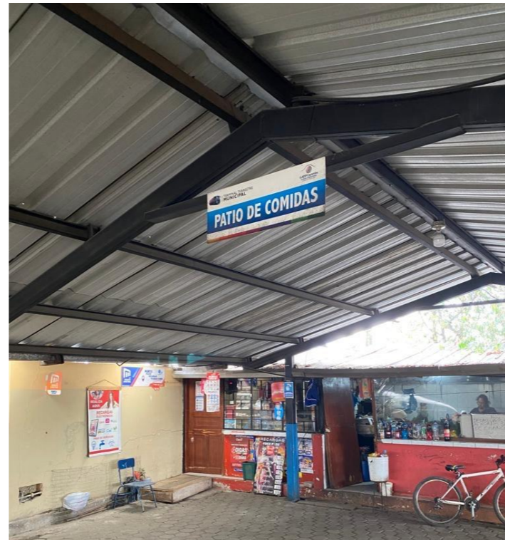
Figura 41: Mal estado del terminal terrestre de Cayambe Fuente: Elaboración propia
