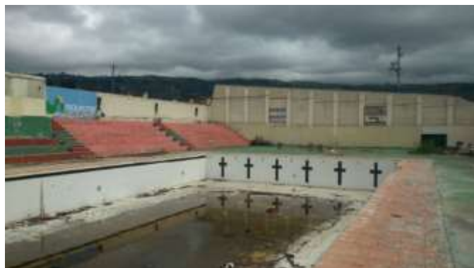
Fotografía 17: Estado actual de la piscina.
