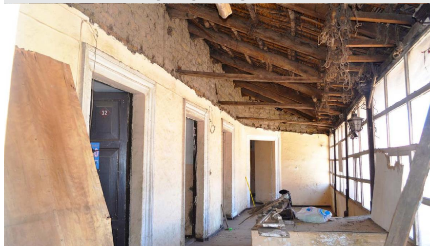
Figura 60: Cubierta en deterioro, Casa Alvimia.
