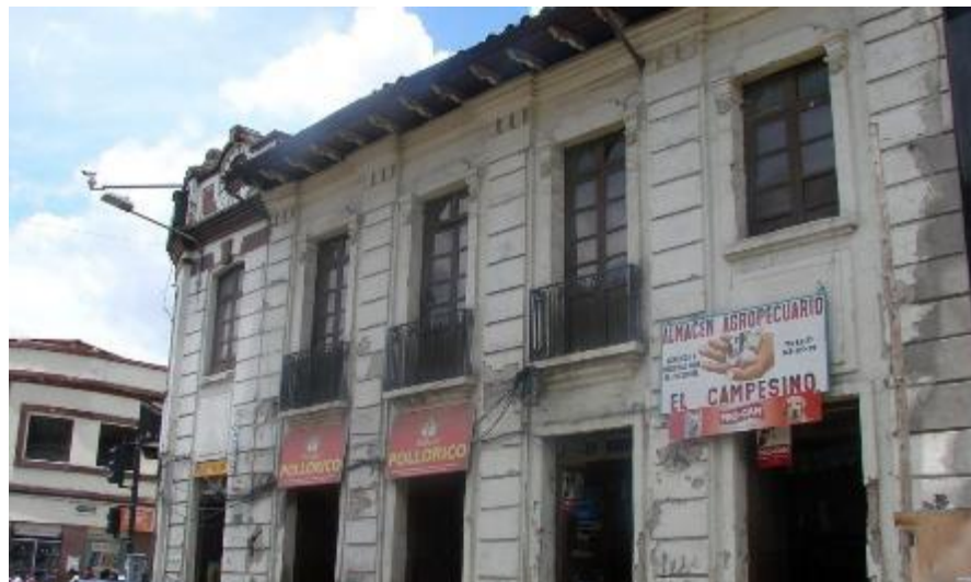
Figura 68: Fachada deteriorada, Casa Neira.
