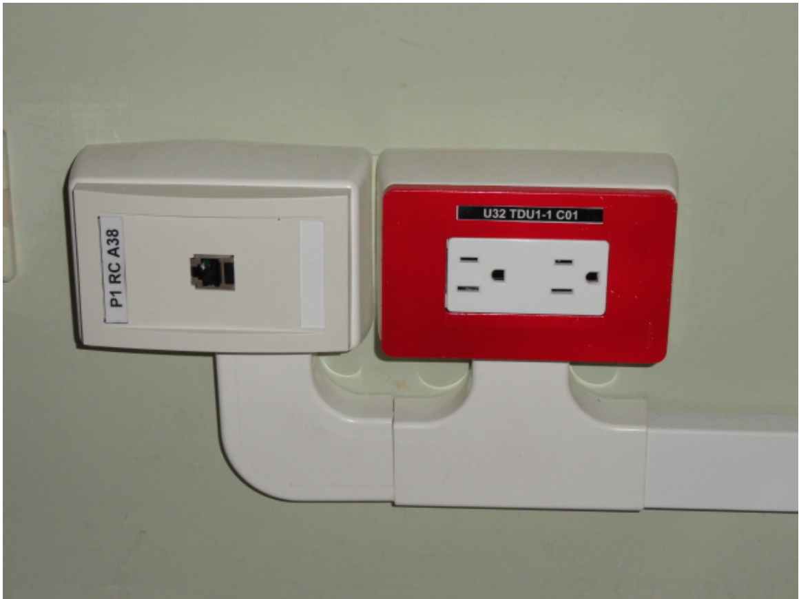
Ilustración 76 - Cajas sobrepuestas y canaletas vistas
