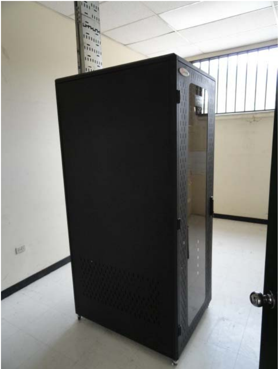
Ilustración 83 - Rack cerrado de piso
