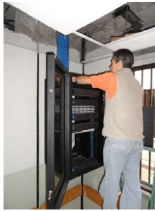
Ilustración 10- Cuarto de telecomunicaciones
