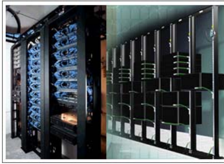
Ilustración 11- Cuarto de equipos
