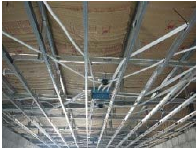
Ilustración 28- Ductos sobre techo falso
