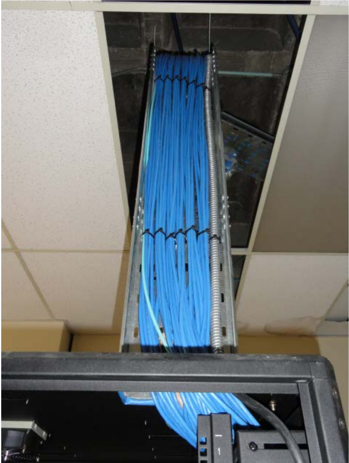
Ilustración 74 - Bajante de bandeja hacia el rack
