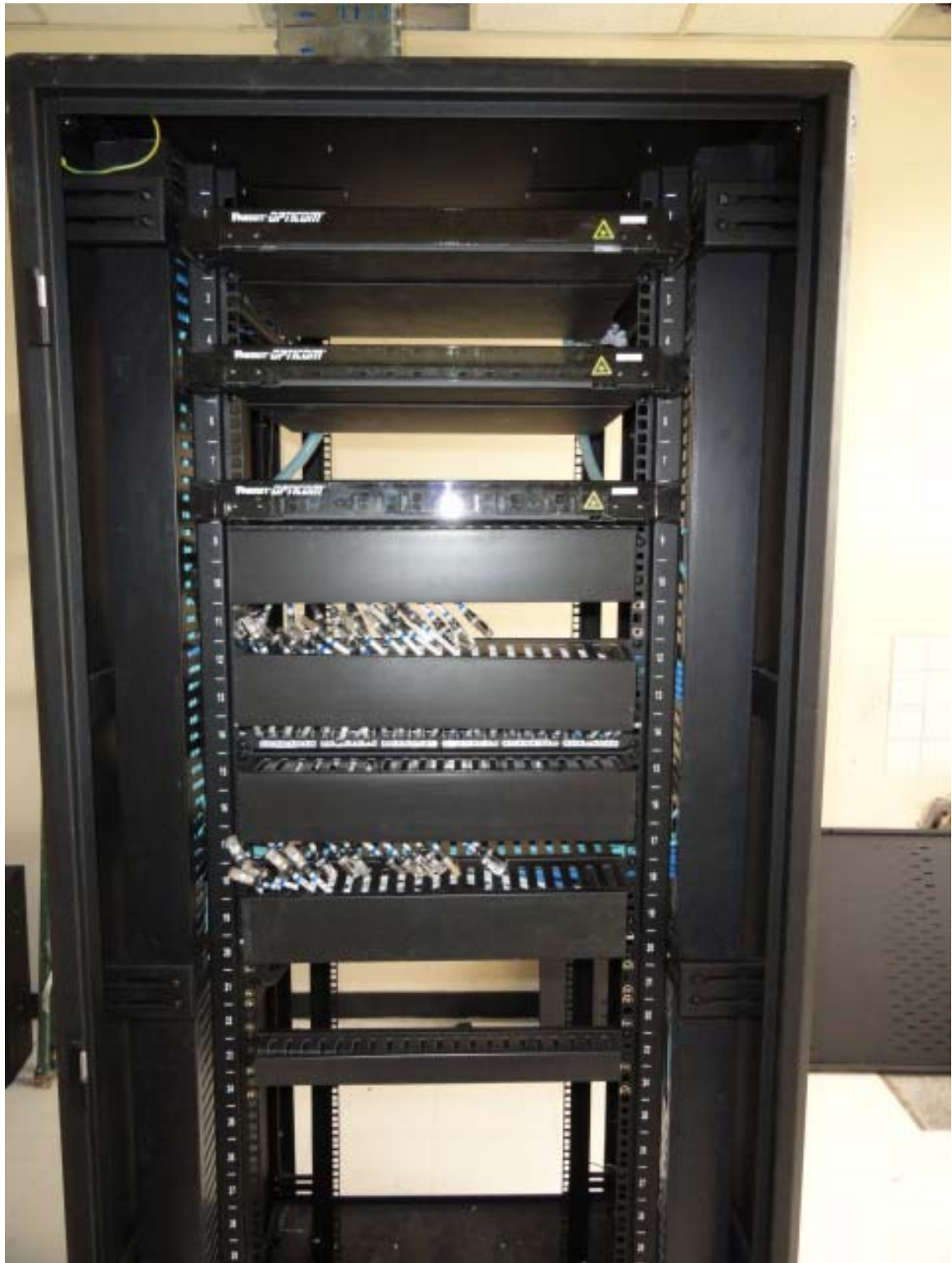
Ilustración 70 - Rack central armado
