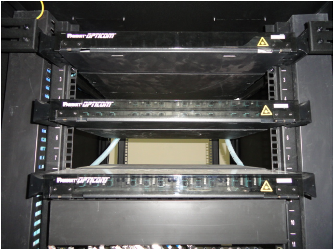
Ilustración 82 - Bandejas de fibra óptica del rack central
