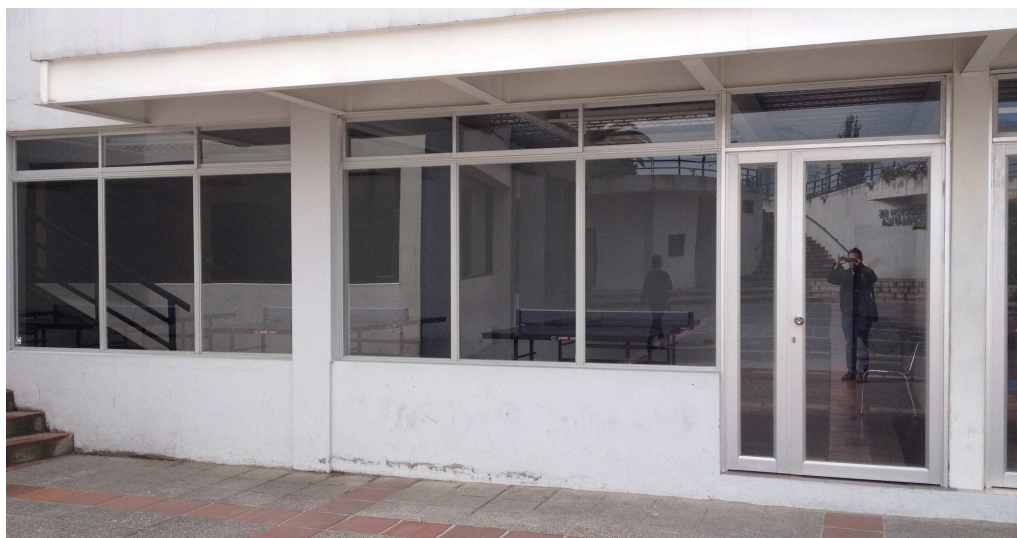
Imagen N° 3: Vista frontal del local propuesto para el almacén de souvenirs de la PUCE
