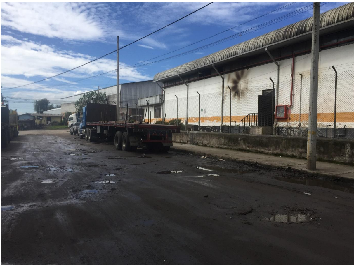
Ilustración 10 Parque Industrial Turubamba, vía del interior del PIT carente de recubrimiento y afectada por el agua.
