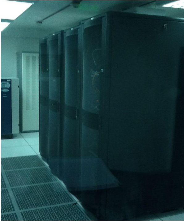
ARMARIO DE EQUIPOS
