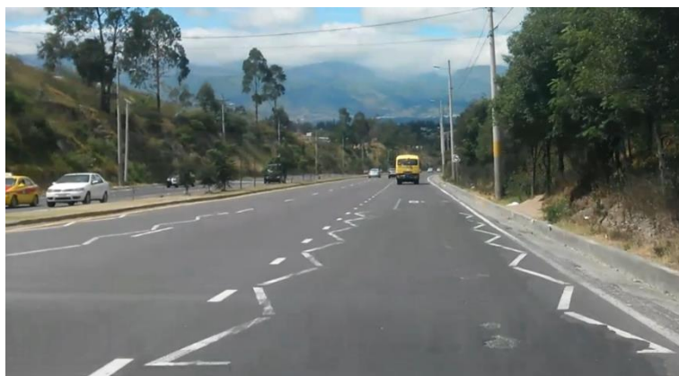
Foto 4-23 Señalización "Parada de bus" sector Panamericana Norte N-S
