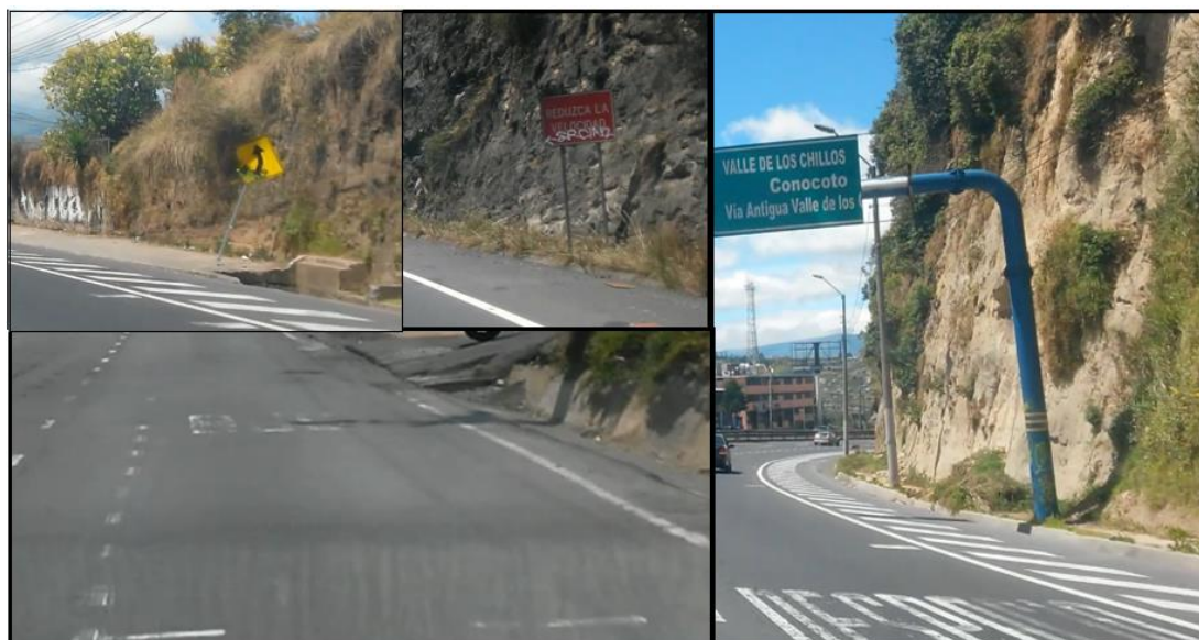
Foto 4-5 Ejemplos de señalización con mal estado de conservación en la Av. Simón Bolívar
