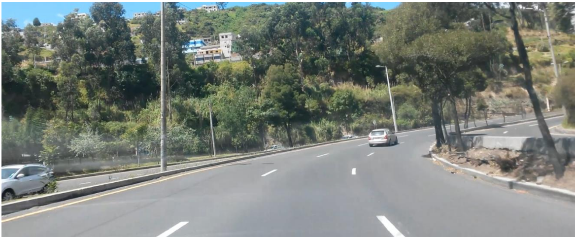
Foto 4-15 Ausencia de señalización vertical y de guardavías curva 60 sentido S-N
