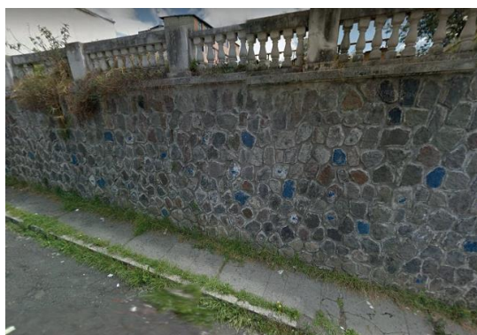
Ilustración 91. Segmento de acera en calle Sincholagua Fuente: (Google Maps, 2023)
