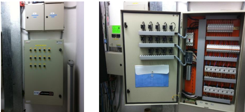
Figura 20: Tableros de control de iluminación – Autoría propia
