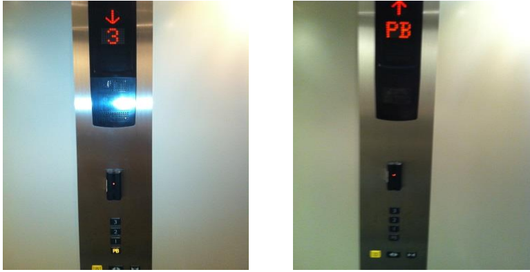
Figura 7: Control de uso de ascensores – Autoría propia
