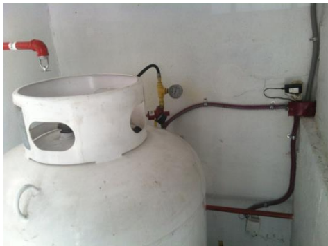
Figura 8: Control de fuga de GLP – Autoría propia
