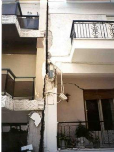
Figura II-9: Daños por golpeteo de estructuras durante sismo (pag.357).(NEC-15, 2015)
