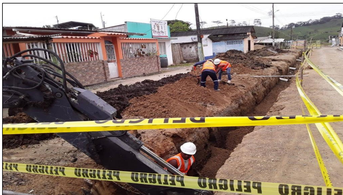
Personal de obreros propensos sufrir riesgos mecánicos
