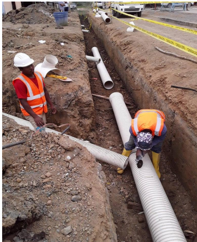
Trabajando con ciertos riesgos mecánicos
