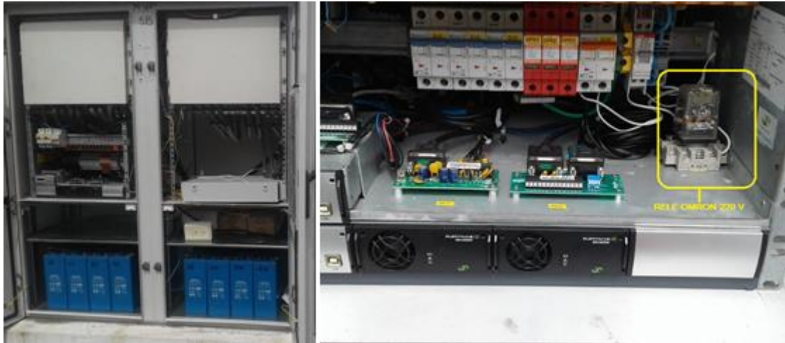
Figura 16: Relé instalado en equipos Alcatel Litespan para generación de alarmas de Falta de Red.
