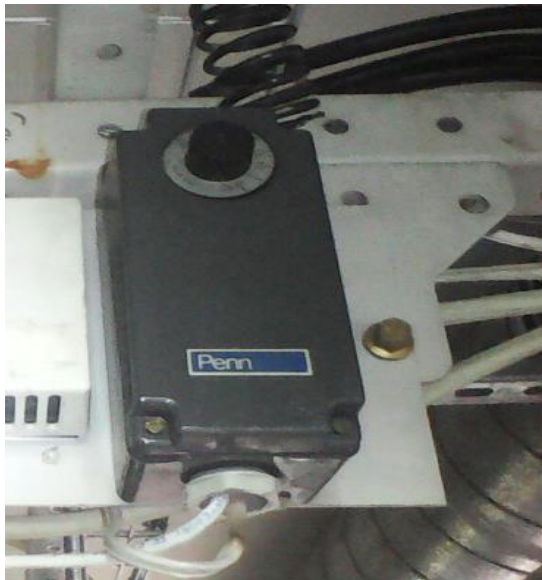
Figura 18: Termostato instalado en central Ericsson TDM Norte, para generación de alarmas de Temperatura peligrosa.
