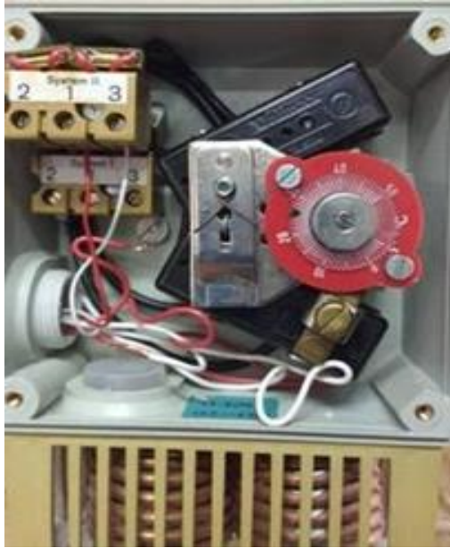
Figura 17: Termostato instalado en central Alcatel TDM Portete, para generación de alarmas de Temperatura peligrosa.
