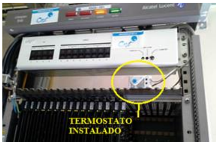
Figura 20: Termostato Estego KTS 011 instalado en Nodo Alcatel Litespan Ferroviaria, para generación de alarmas de Temperatura peligrosa.
