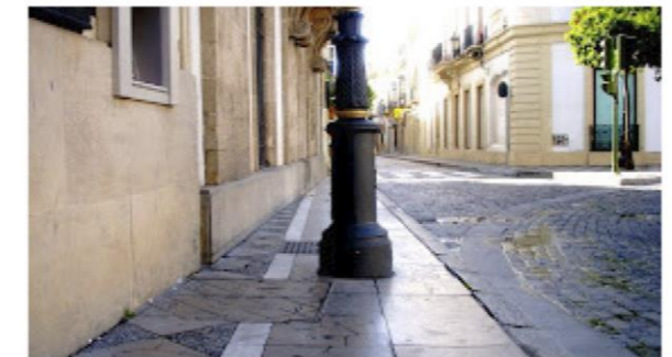
Figura 70: Aceras con barreras arquitectónicas.
